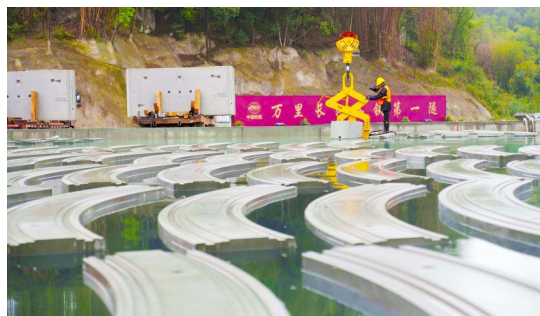
3月24日,在中铁十四局重黔铁路站前2标管片场,工人正在水池进行管片入水养护作业。
