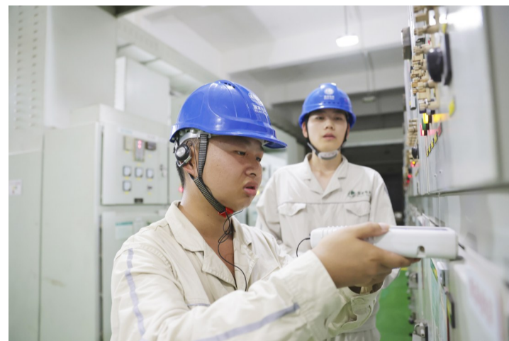
7月11日,巡检人员对开关柜进行全方位检测。 记者 向金城 摄
