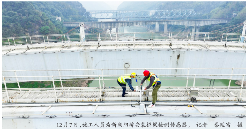
12月7日,施工人员进行新朝阳桥安装桥梁检测传感器。记者 秦廷富 摄
