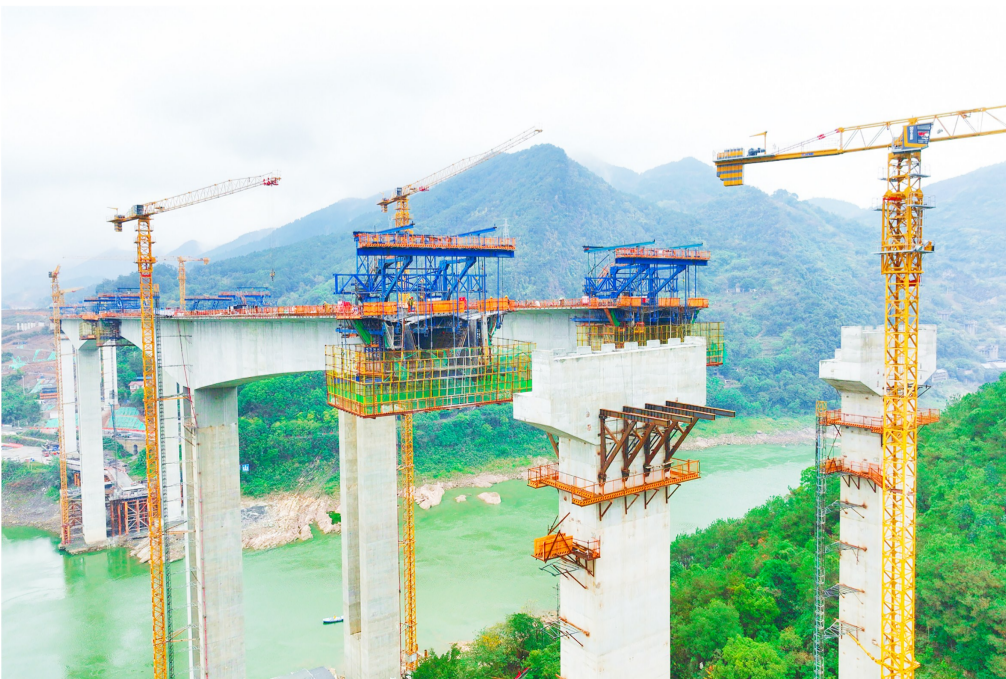
12月1日，在渝武高速公路复线观音峡嘉陵江特大桥施工现场，施工人员进行桥面浇筑施工作业。 记者 秦廷富 摄
